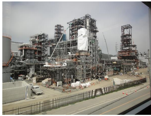
Fig.6.b (右) 排熱回収ボイラ他
